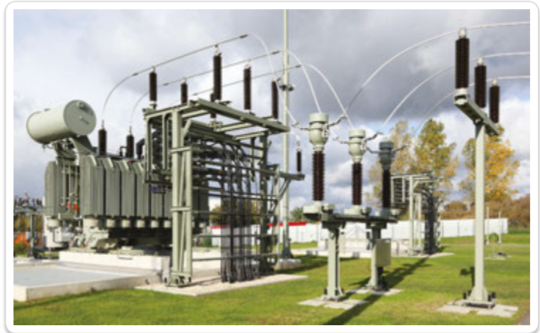
Görsel 2.35 Transformatörler akımın taşınması sırasında oluşan güç kayıplarını azaltmak için de kullanılır.
