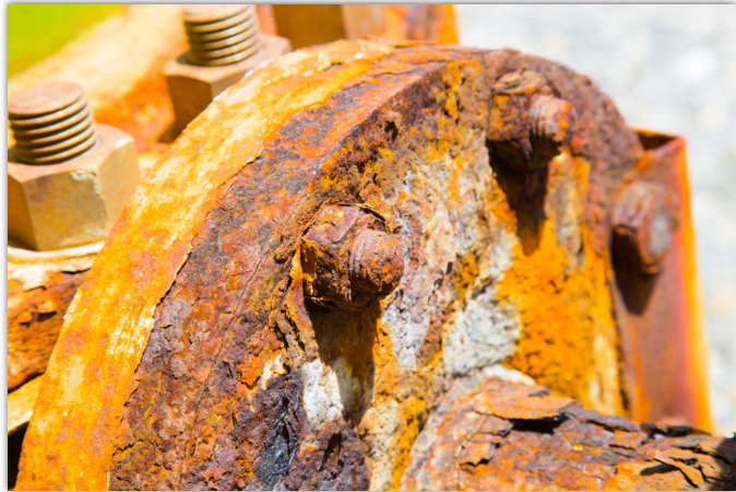
Görsel 2.19: Demirin oksitlenmesi
